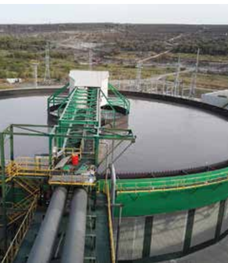
Eindicker im Betrieb
