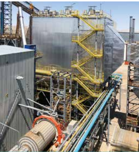
Elektrofilter und Kugelmühle (nass)
